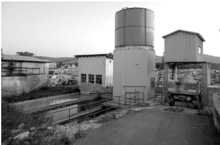
Slika 6.: Postrojenje za čiščenje tehnološke vode Marmor Sežana.
